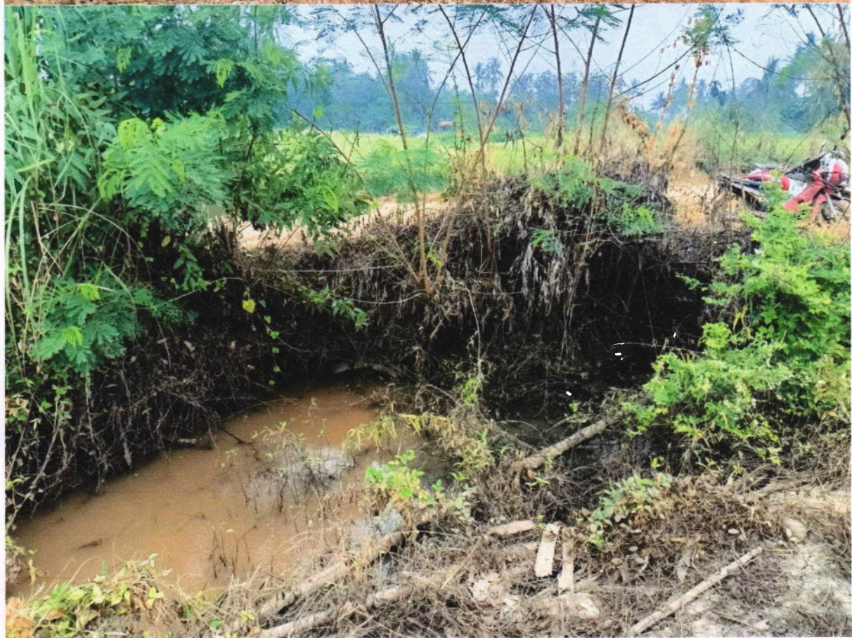
จุดที่ 2 ตรงถนน กอวังน้อย ชำไปทนายเสาดร อินทร์ - ถนนชำรุด ไม่สามารถสัญจรได้
